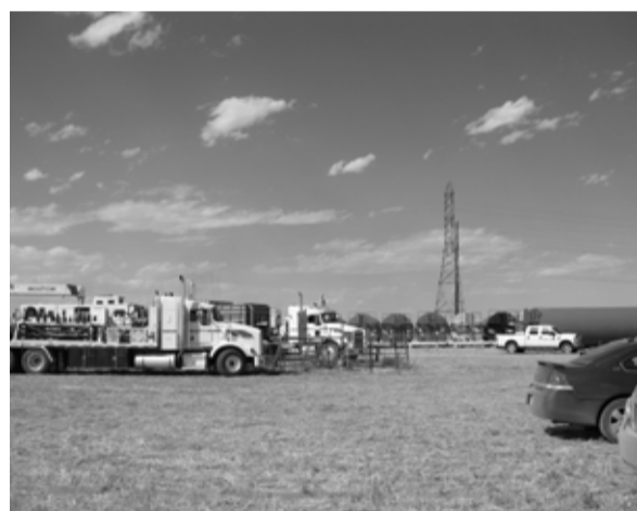
Eine „Fracking-Site“ in der Nähe von Platteville, Colorado. Foto: flickr.com, Mark udall (CC BY-NC-SA 2.0)
