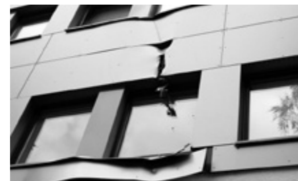
Krawäng! Da ist der Baum voll an der Fassade langgewätscht.
